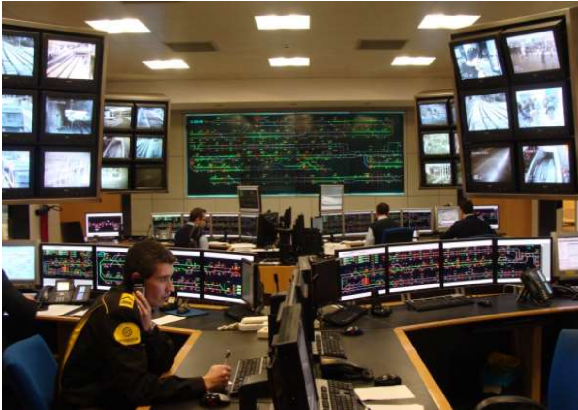
Figura 64 - Aspecto geral da Sala Principal do PCC
