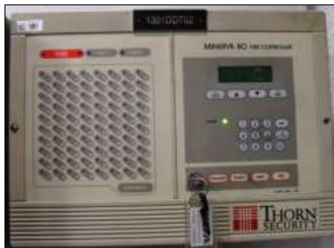
Figura 76 - Central de Detecção de Incêndio
