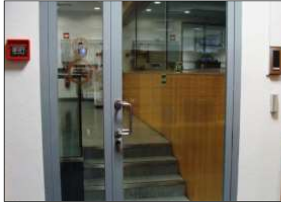
Figura 74 - Porta de acesso ao PCC com controlo de acessos e intercomunicador
