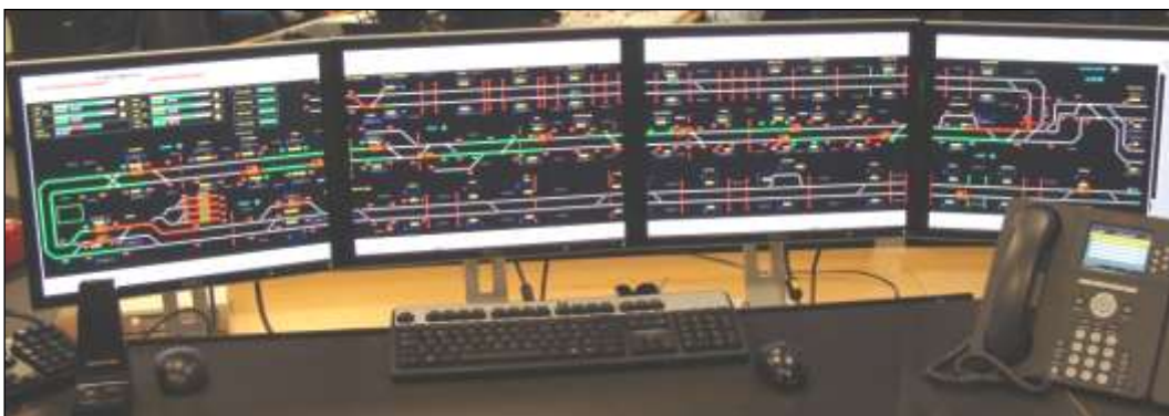
Figura 67 - Terminal de TMS
