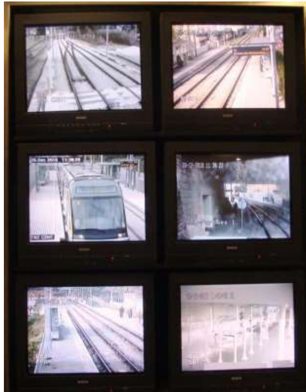
Figura 69 - Monitores de CCTV
